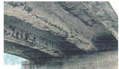
塩害劣化の状況
